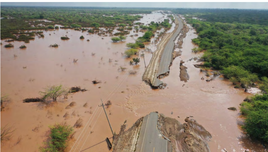
Die Wassermassen haben wichtige Strassen in der Region zerstört.
